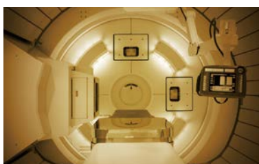
陽子線治療センターのガントリー照射室 ガントリーを360°回転させることで、どの方向からでも陽子線を照射できます。
