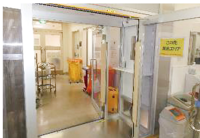
救命救急センター 陰圧装置
