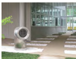
室外のクールチューブ(吸込み)
