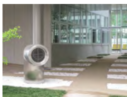
室外のクールチューブ(吸込み)
