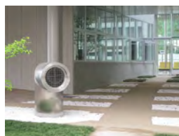
室外のクールチューブ(吸込み)
