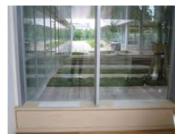
室内のクールチューブ(噴出し)
