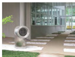
室外のクールチューブ(吸込み)
