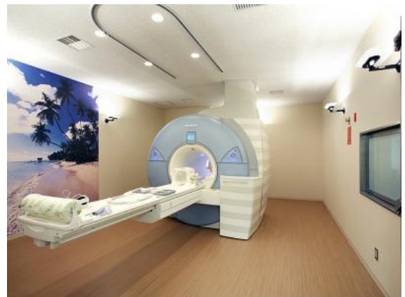
MR I 検査設備
